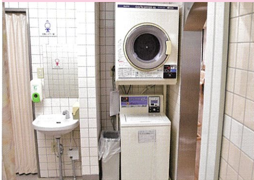
洗濯機・乾燥機
